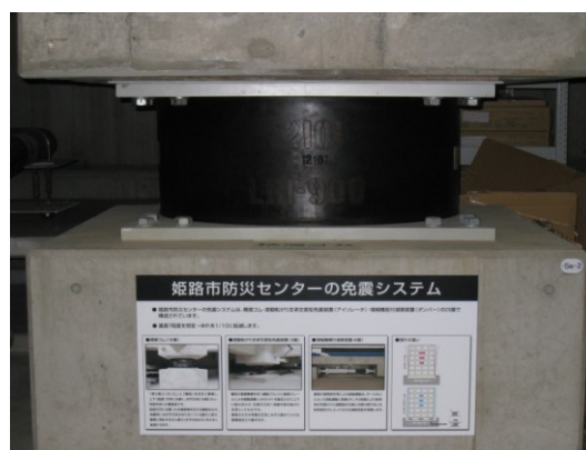
基礎免震装置
